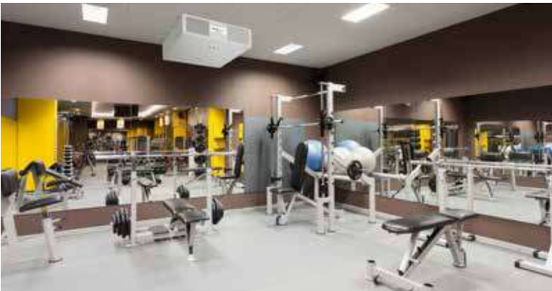
VMCS600/VMCS1200 Deckeninstallation in einer Turnhalle. Die Wahl der Wohneinheit richtet sich nach der maximalen Anzahl der Bewohner. VMCS600/VMCS1200 ceiling installation in a gym room. The choice of the model will be based on the maximum number of occupants.
