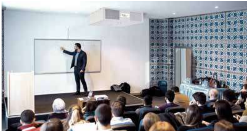
Instalación VMCS600 / VMCS1200 en el techo del aula. La elección de la unidad se hará en función del número máximo de ocupantes. VMCS600/VMCS1200 ceiling installation in a training room. The choice of the model will be based on the maximum number of occupants.
