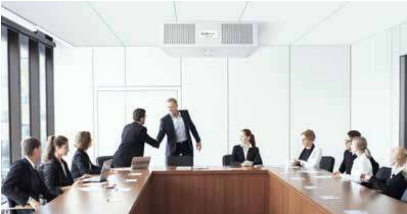
VMCS600/VMCS1200 montaj la tavan într-o sală de ședințe. Alegerea modelului se va face în funcție de numărul maxim de ocupanți VMCS600/VMCS1200 ceiling installation in a meeting room. The choice of the model will be based on the maximum number of occupants.
